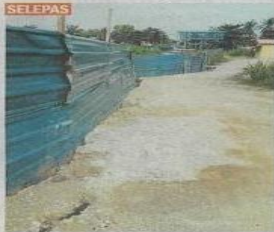
Runtuhan tebing yang sudah dibaik pulih oleh kontraktor terlibat.
