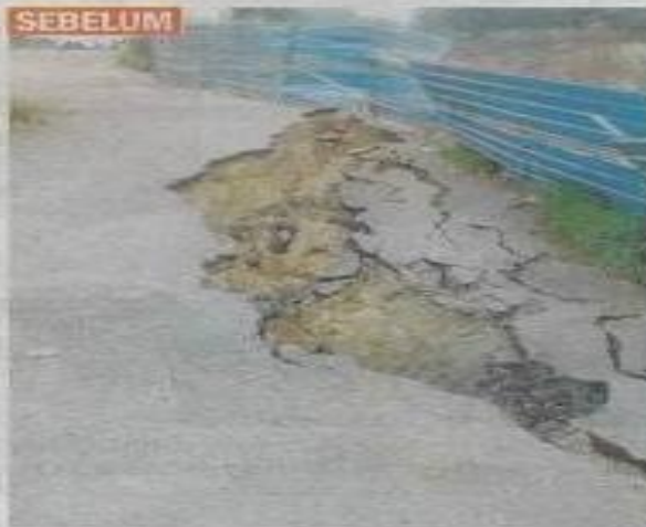
Tanah runtuh menjejaskan keselamatan penduduk di pangsapuri berdekakatan.
